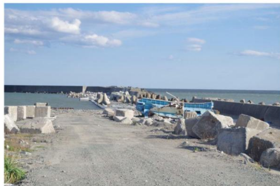
福島県、浪江町の防波堤です。 津波によって漁船が打ち上げられています。
